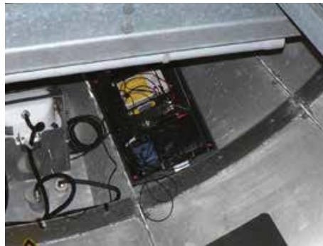
Microphone déporté, installé sous la nacelle (photo du haut) et connecté au détecteur automatique d'ultrasons à l'intérieur de la nacelle (photo du bas). © L. Bach
